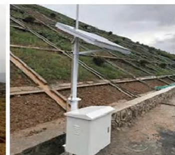
一体化渗压监测
